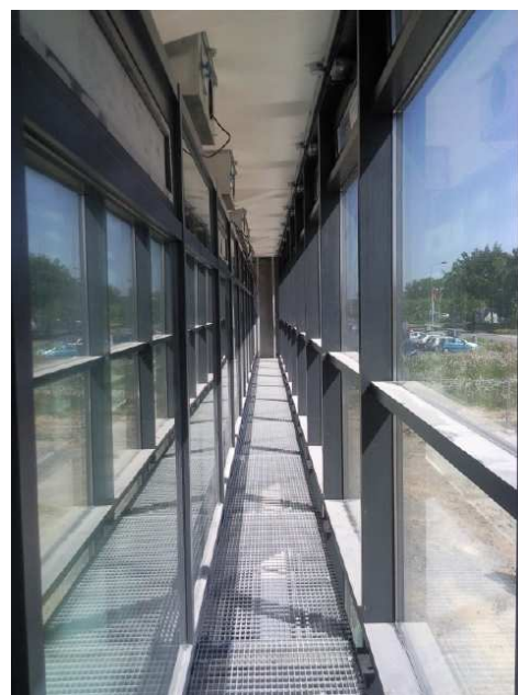
Les façades nord et sud du bâtiment sont équipées de parois vitrées double peau.
